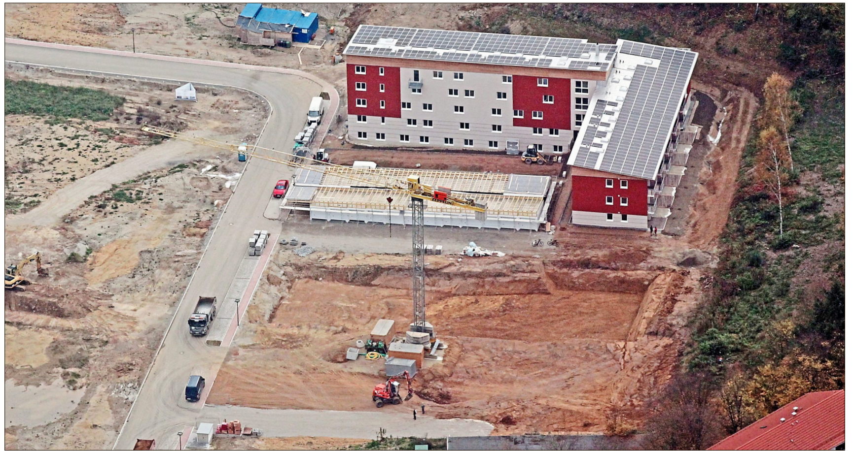
Die Baugrube ist schon ausgehoben, der Kran steht bereit: In den kommenden Tagen beginnen die Bauarbeiten am zweiten Bauabschnitt des Seniorengerechten Wohnens auf dem ehemaligen Ziegeleigelände. (Fotos: gt)
